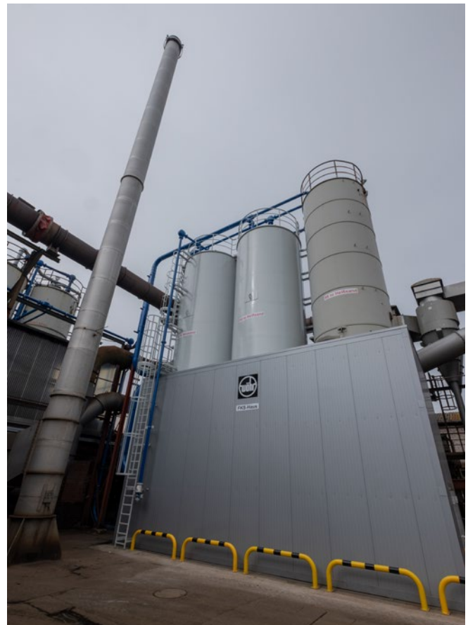
Abb. 18 Sand-Silo und Formstoff-Mischstation im Außenbereich
