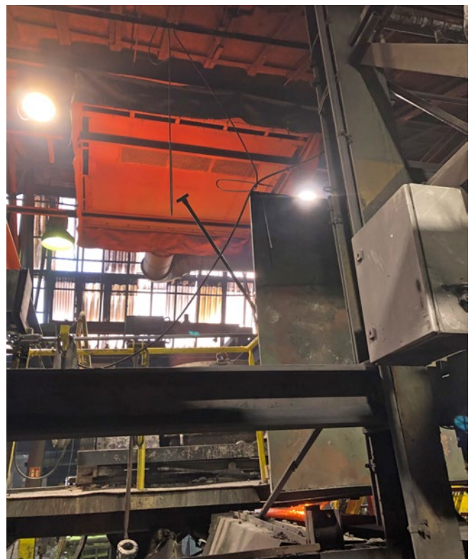
Abb. 11 Erfassungshaube im Schmelzbetrieb
