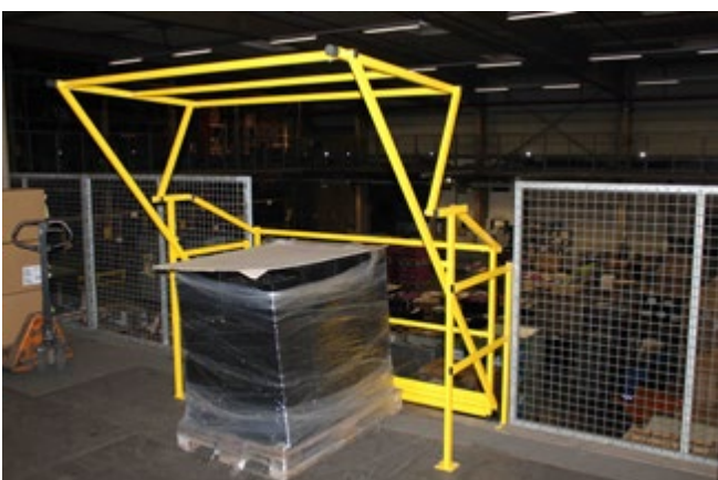
Abb. 3.4.3-05 Sicherheitschleuse für Lagerbühne
