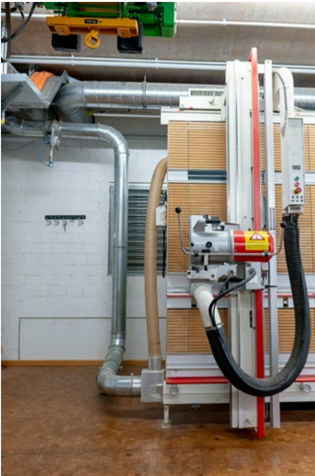
Abb. 3.1.2-07 Absauganlage an einer vertikalen Plattensäge
