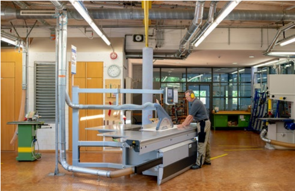
Abb. 2.2.3-01 Absauganlage an einer Holzbearbeitungsmaschine
