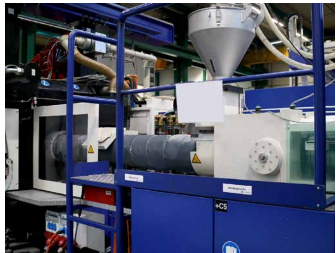
Abb. 14 Best Practice für eine Aufstiegshilfe und Absturz-sicherung an einer Spritzgießmaschine. Bitte beachten Sie: Der Transport von Werkzeugen oder anderen Gegenständen darf die sichere Nutzung von Steigleitern einschließlich Persönlicher Schutzausrüstungen gegen Absturz nicht beeinträchtigen.
